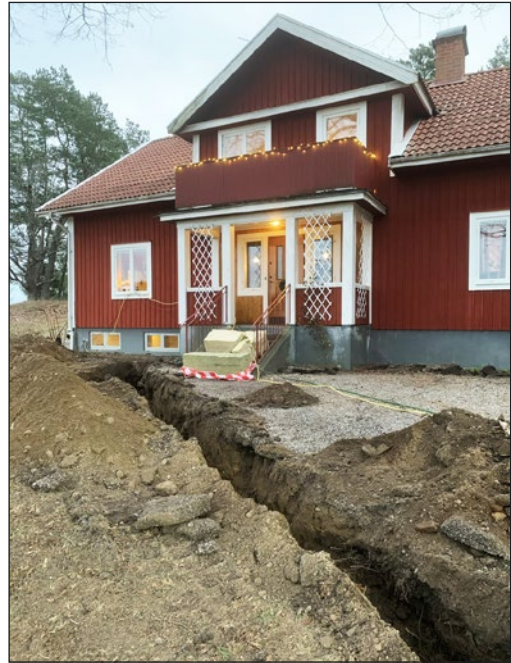
Figur 7. Schaktet med A2 beläget i högra delen av bilden. Foto från sydväst.
