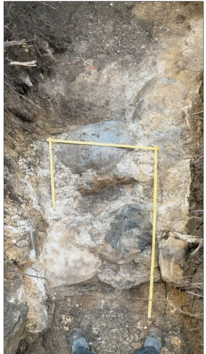
Figur 7. Lodfoto av muren i schaktet för utloppsörret.
