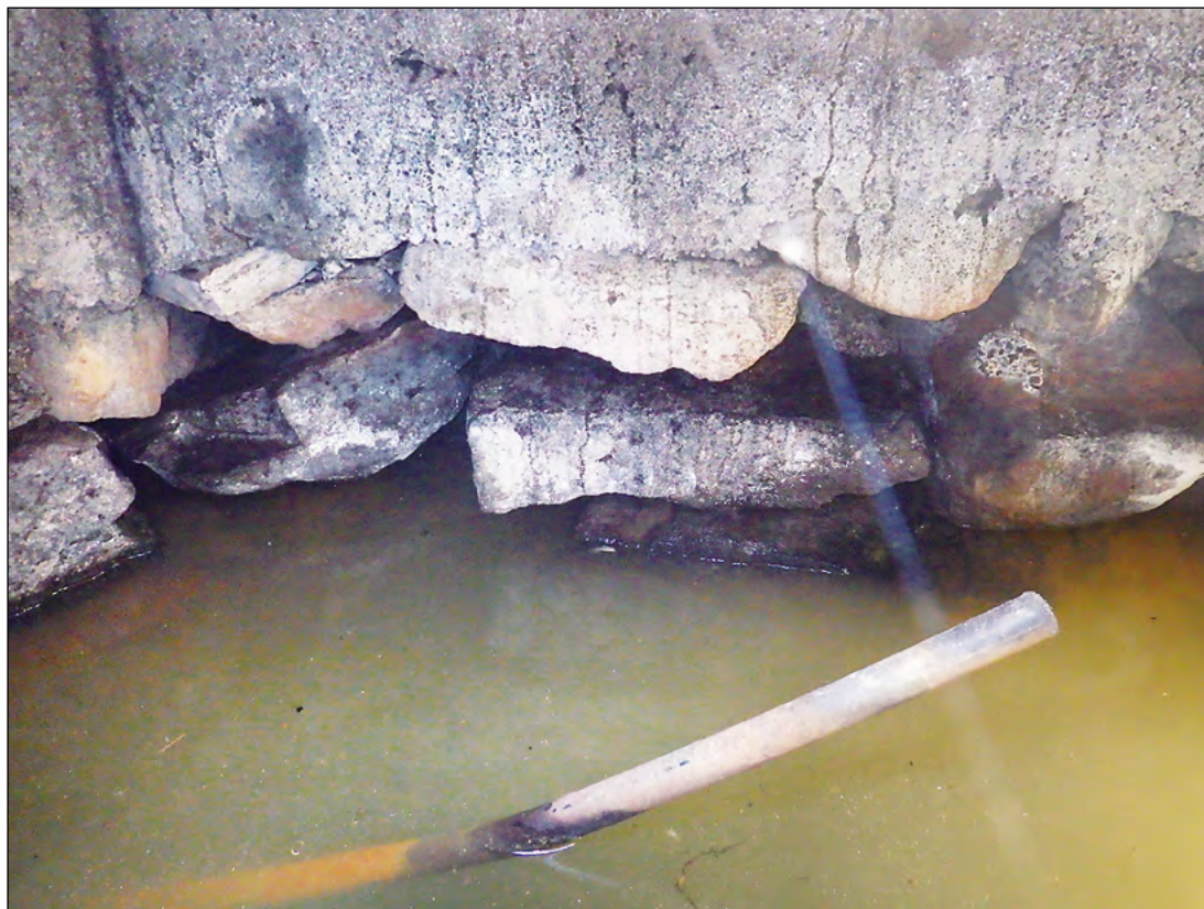
Figur 17. Foto taget i brunnen som utgör objekt 8. Brunnens äldre del består av en kallmurad konstruktion som vid senare tillfälle fått en överdel med gjuten betong. I vatten ligger den övergivna pumpstången kvar.
