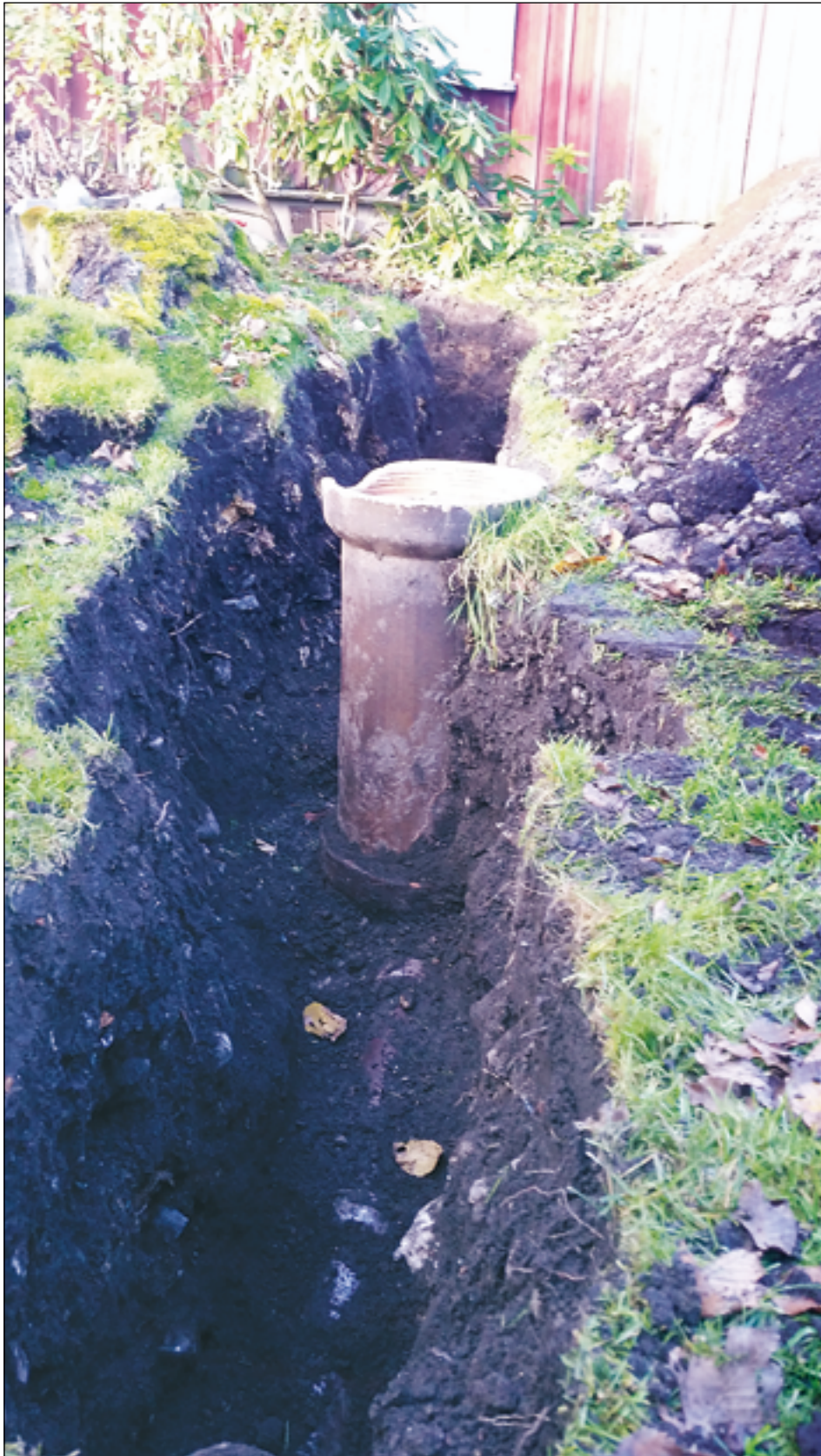
Figur 6. Schakt 6 i områdets norra del där befintlig brunn och ledning kan ses. Foto av Arkeologgruppen AB.
