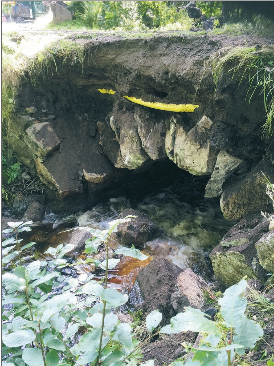
Figur 4. Elledningen som blev synlig när den norra sidan av bron rasade. Foto från norr taget av Nina Balknäs.
