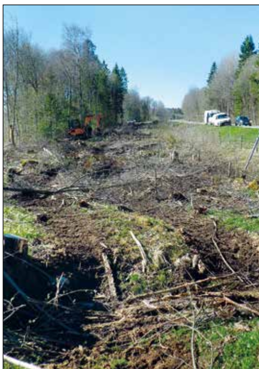
Figur 63. Södra delen av objekt 19. Marken var sönderkörd och sly täckte hela ytan. Vid fototillfället hade ett larvband på grävmaskinen nyligen lossnat efter körning i de leriga körspåren. Foto från nordöst.
