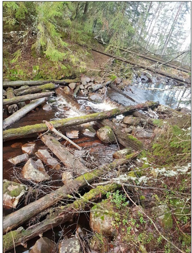
Figur 45. Dammvall (objekt 8), vid Hällsjöns utlopp i Hällsjöbäcken, anlagd åren 1912-1913. Dammluckan är utriven och i dammöppningen ses nedrasade stenar från dammvallens sidor och slussbotten bestående av två timmervarv. Foto från väster.
