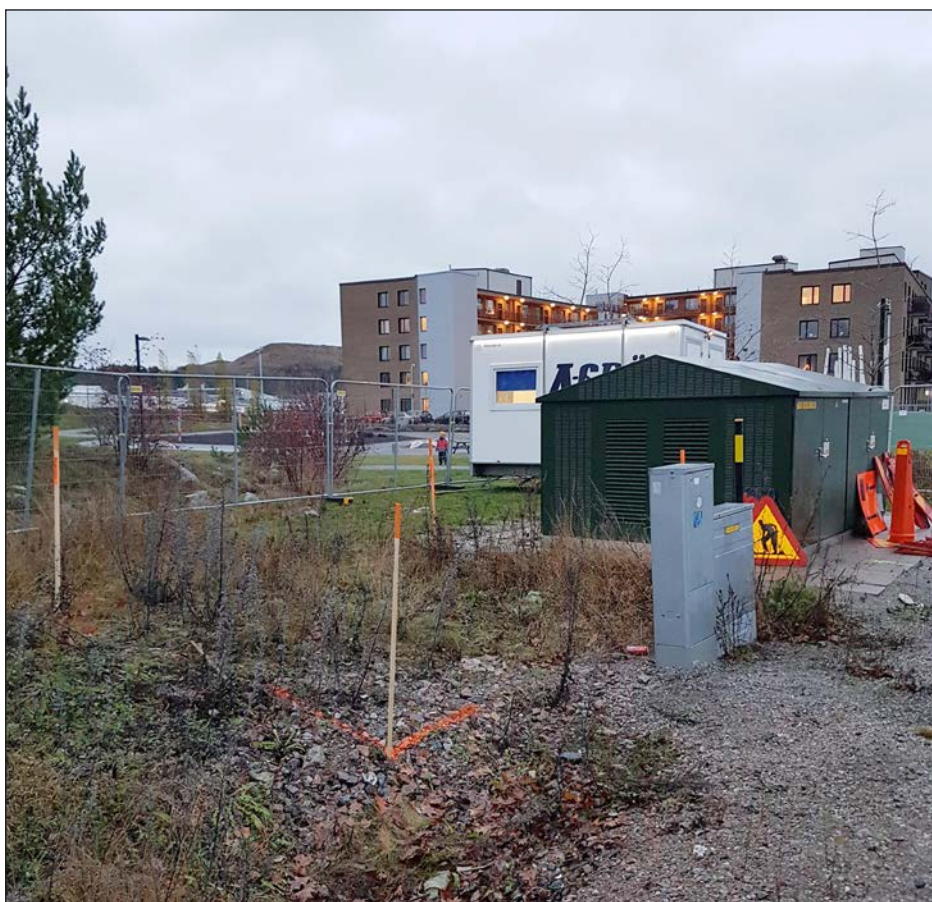
Figur 4. Käppar och orange markering visar placeringen för den nya nätstationen. Foto från sydväst.
