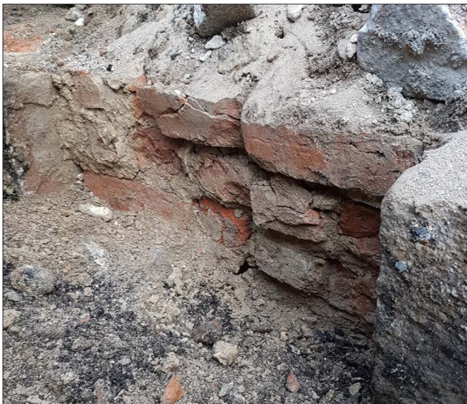
Figur 9. K1. Tegelförstärkningen som framkom bakom kantstenarna.
