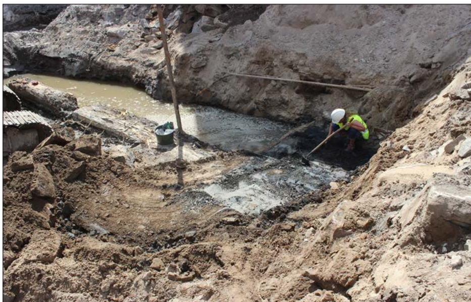
Figur 15. Ebba Knabe undersöker brandlagret i rum 4. Notera vattnet som trängt upp till vänster i bild. Foto från nordväst.
