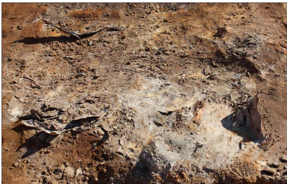
Figur 27. Under trägolvet i rum 3 har näver använts som isoleringsmaterial och fuktspärr.
