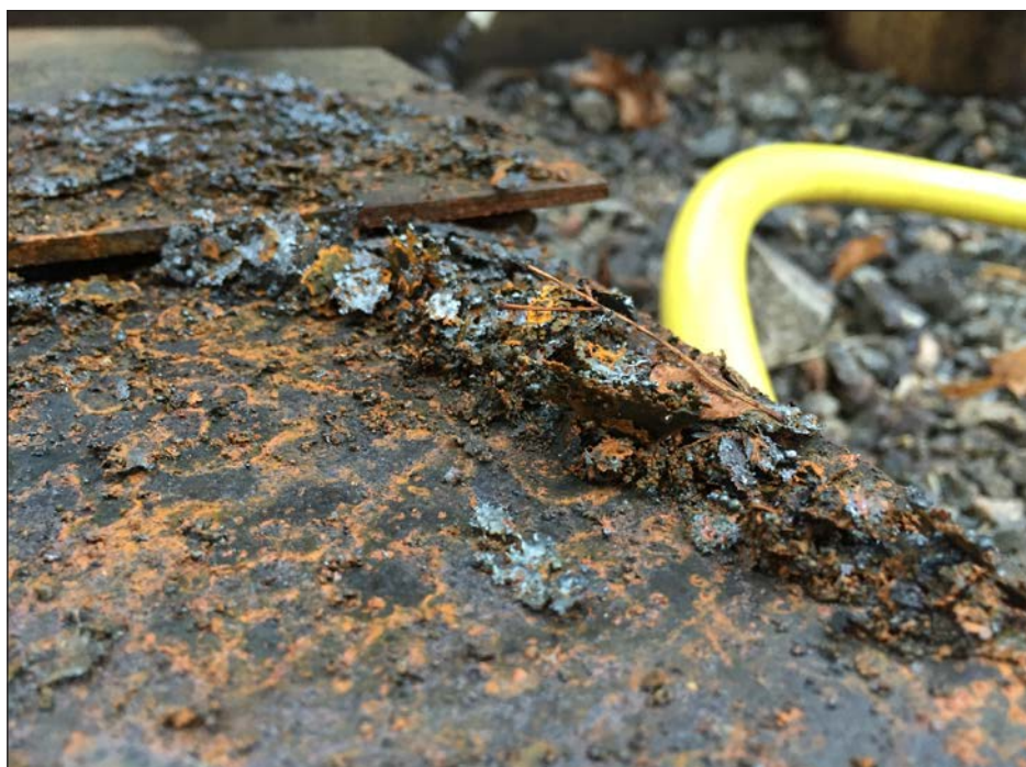
Figur 47. Brakor som uppstått vid kapning av järnplåtar med svets vid ett modernt bygge.
