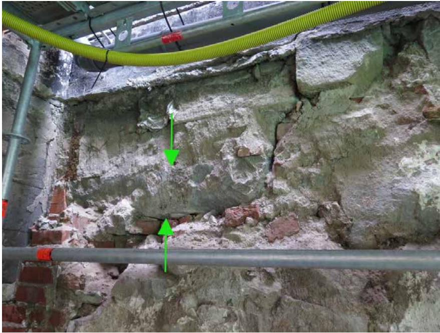
Figur 6. Ett större stenblock (markerat med pilar) kan ha utgjort en tröskel till en igensatt öppning i bottenvåningen. Foto: A.B, SSM10020000.
