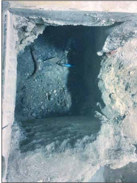
Figur 6. I botten av rökgången syns bland annat en rostig elkabel som utpekas av skårsleven. Skala 1:50.
