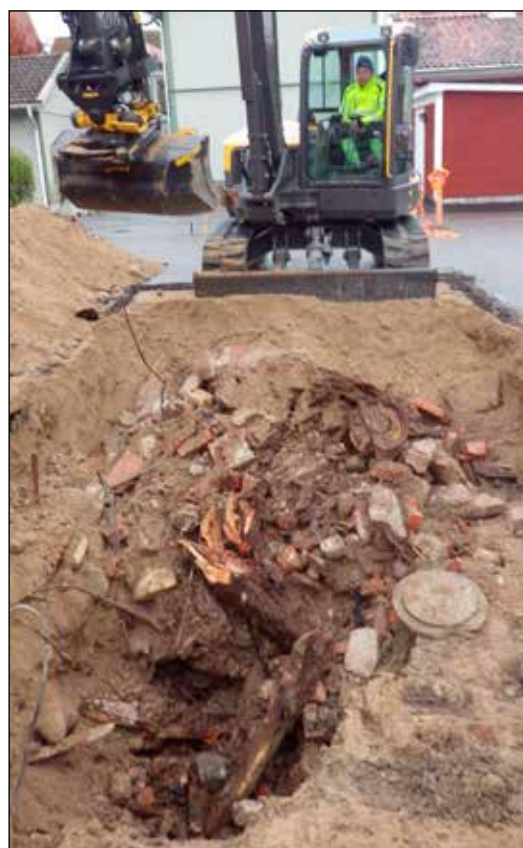
Figur 55. Rasmassor i schakt 500 efter byggnad försedd med källare. Foto från öster.
