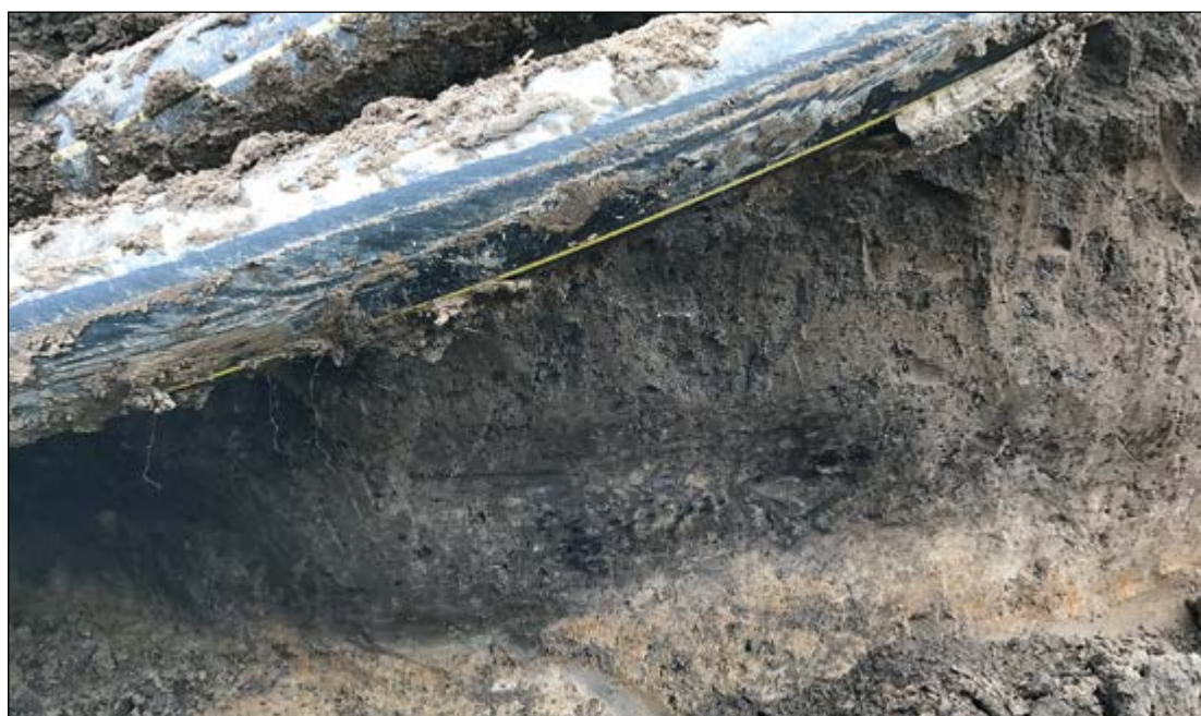
Figur 16. Nedgrävningen A21 i östra schaktväggen, skadat av tryckt ledning. Foto taget från söder.
